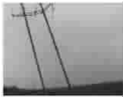
图 5 拉线被盗后倾斜的杆塔
