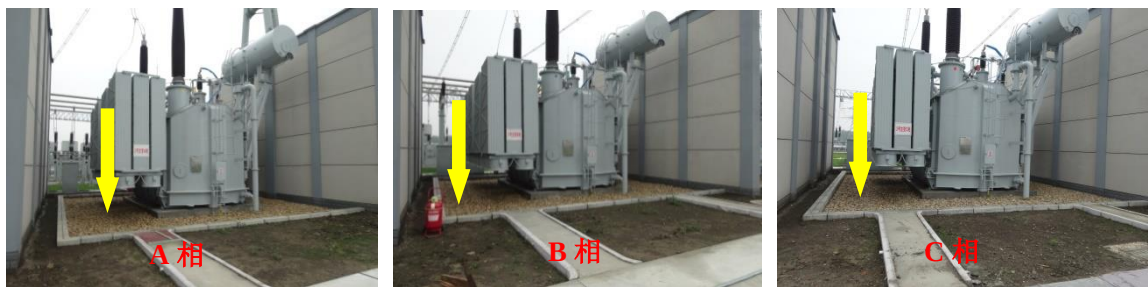
图 12-1 500kV 高邮变#3 主变下方事故油坑
