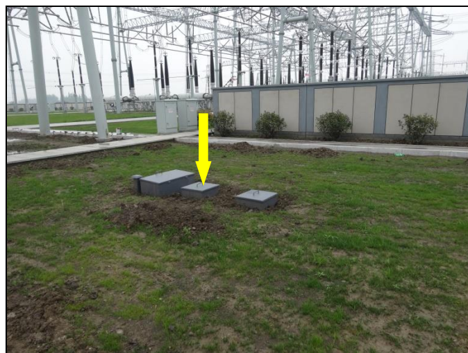
图 9-2 500kV 高邮变电站内新建地埋式生活污水处理装置
