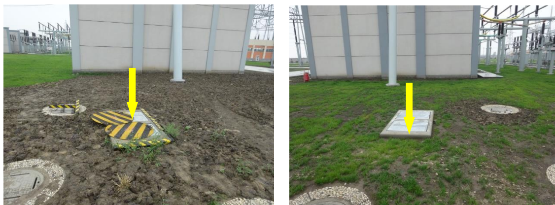
图 12-3 500kV 高邮变电站事故油池
