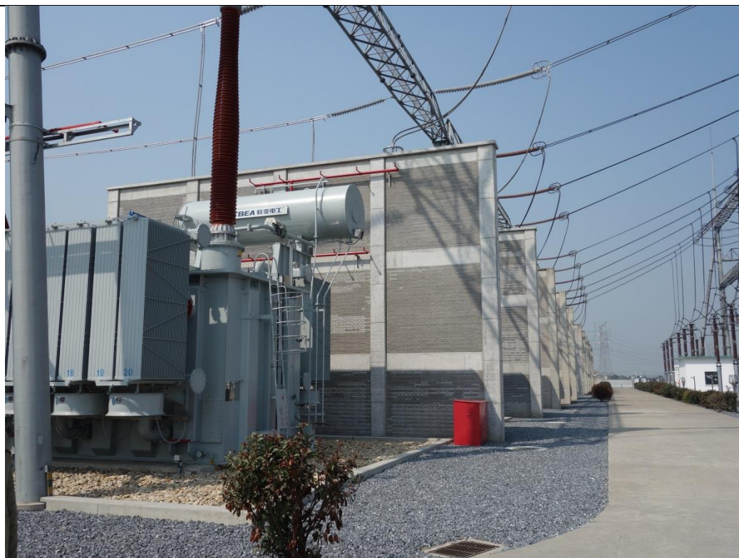
图 3.1-3 500kV 凤城变本期扩建主变
