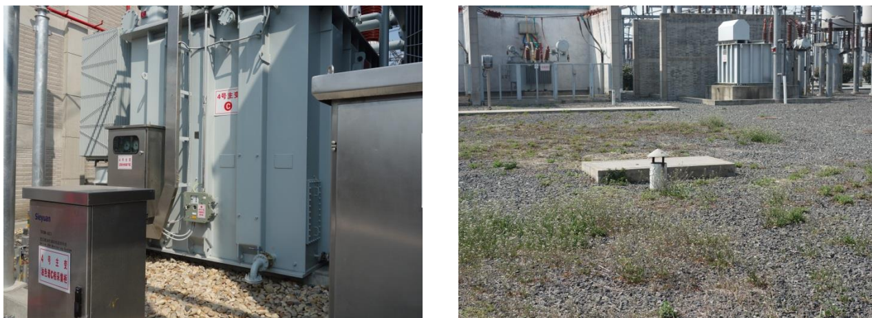
图 12.1-1 变电站本期主变事故油坑及已建事故油池现状
