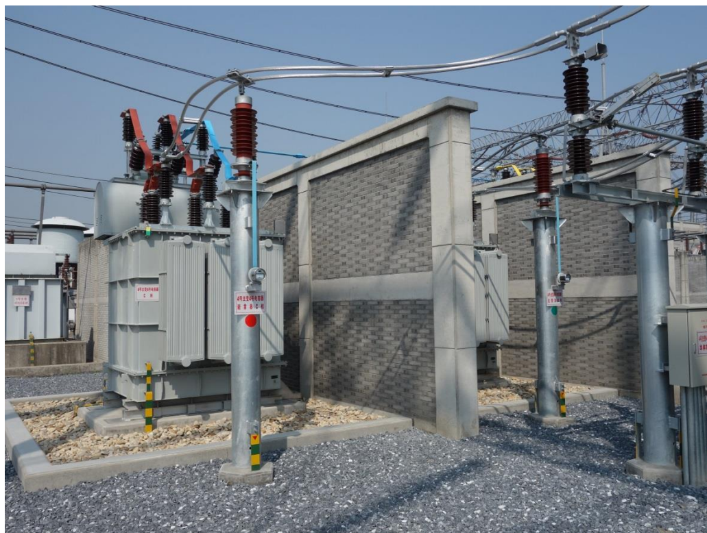
图 3.1-4 500kV 凤城变本期扩建低压电容器
