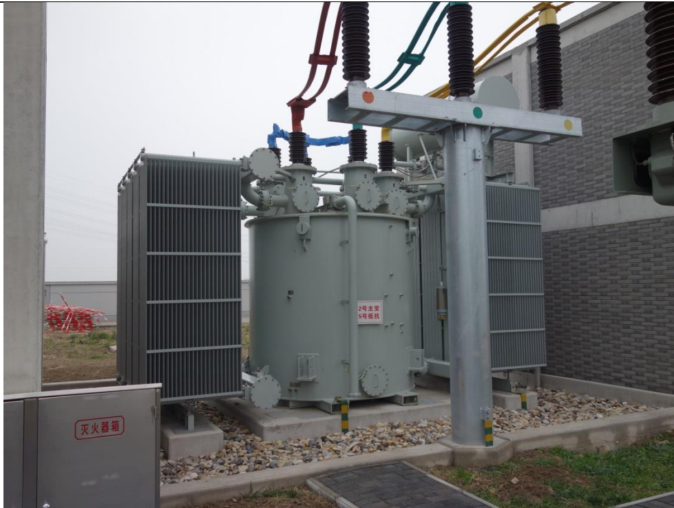
图 3.1-4 500kV 双草变本期扩建低压电抗器
