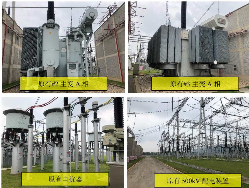
图 3-5 500kV 廻峰山变电站原有工程
