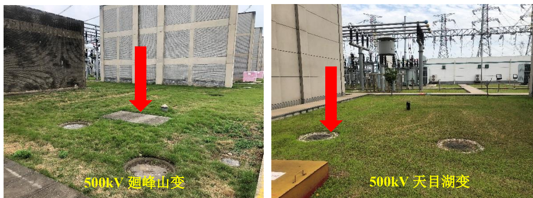
图 12-1 各变电站事故油池
