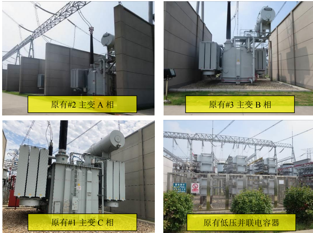
图 3-9 500kV 天目湖变电站原有工程
