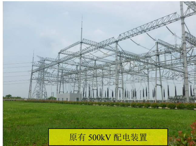
图 3-1 500kV 西津渡变电站原有工程
