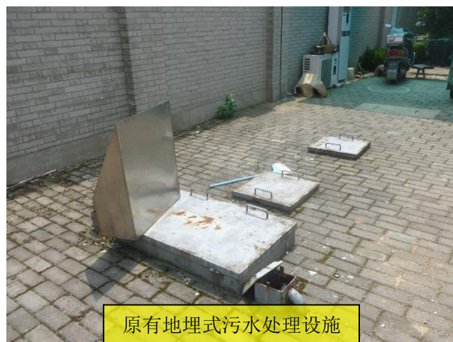
图 3-2 500kV 西津渡变电站原有工程环保措施
