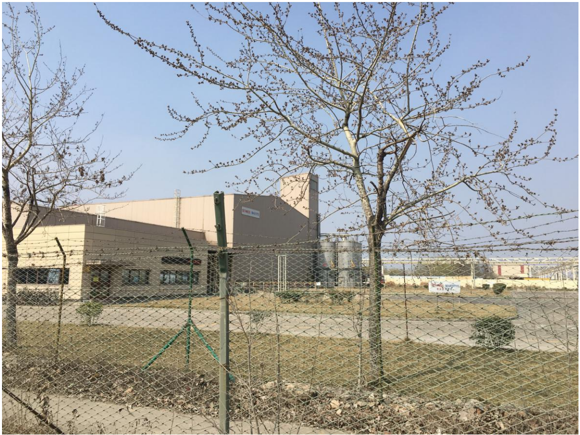
罗盖特升压站
