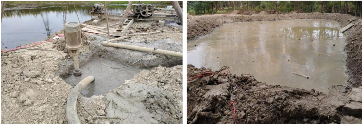
图 1.4 泥浆循环池和泥浆沉淀池
