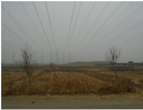
220kV 艾蔷 4W91/4W92 线 #54~#55 杆塔一档跨越鲁兰河照片
