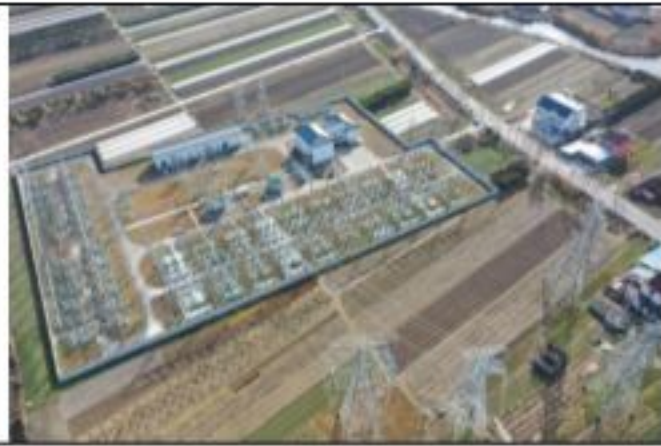
220kV 金东变电站 2020.1.28
