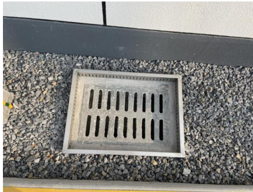
4-1 (a) 变电站区雨水口
