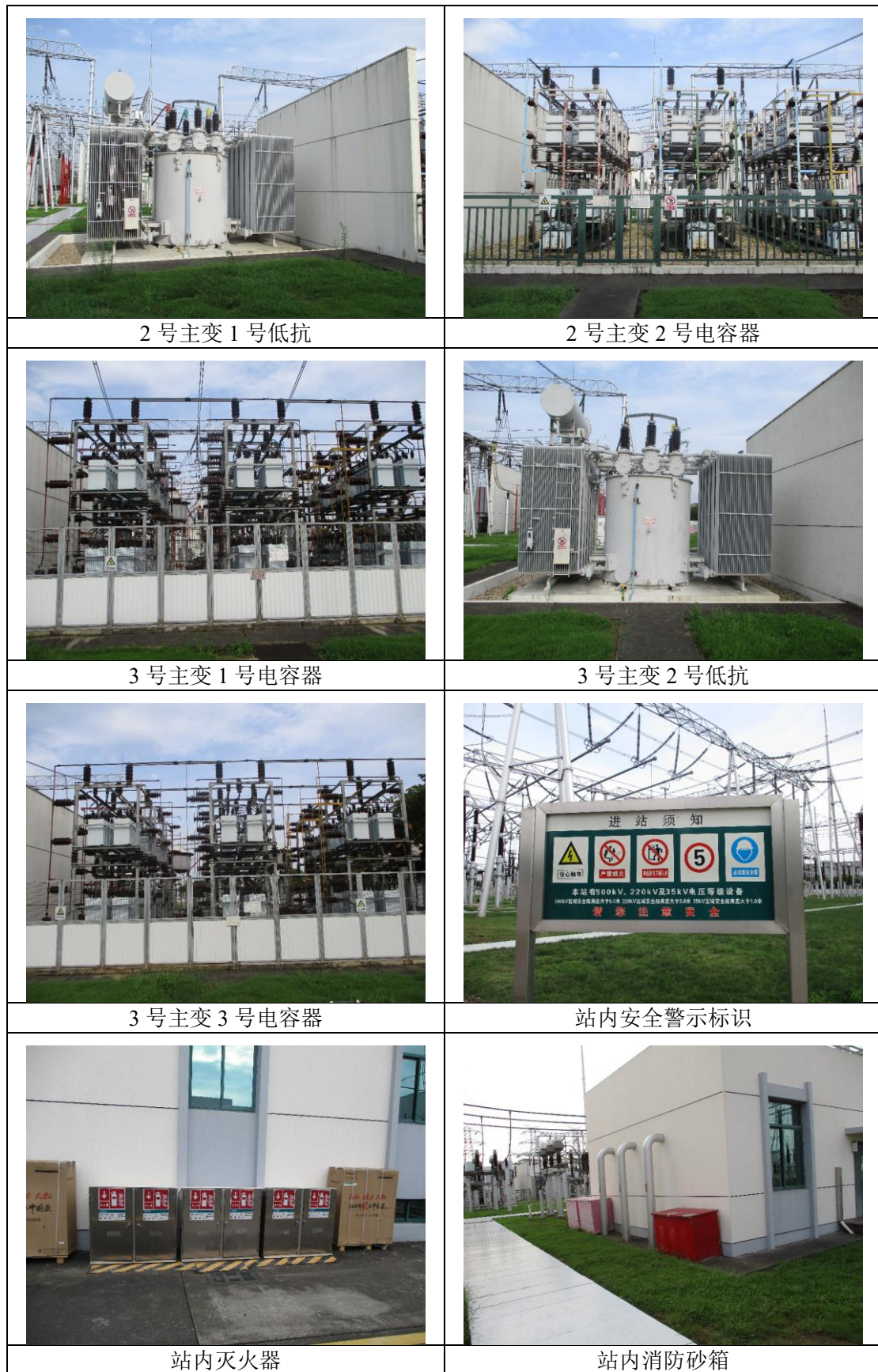
图 3-1 变电站前期规模设施照片
