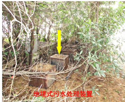
图 9-2 站内地埋式污水处理装置
