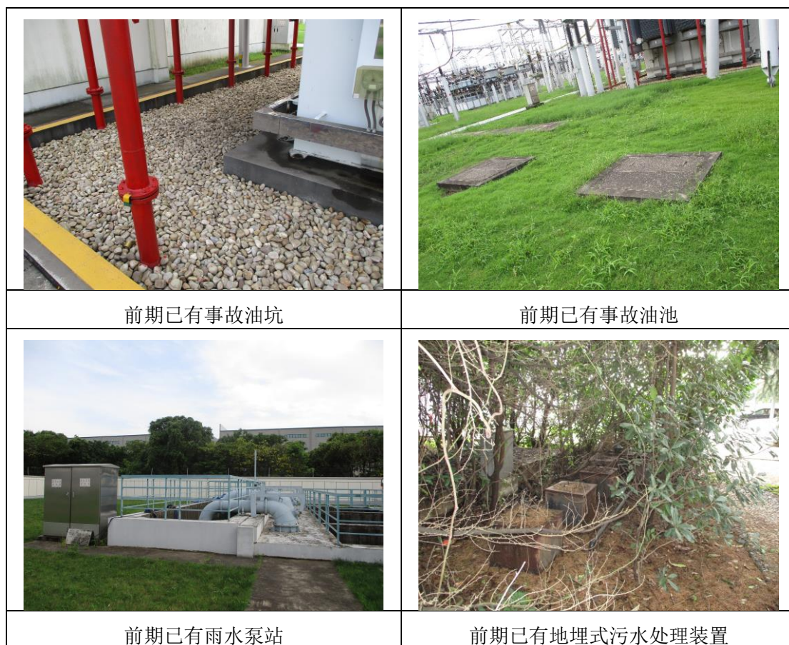
图 3-2 变电站前期环保设施照片
