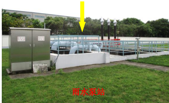
图 9-1 站内雨水泵站
