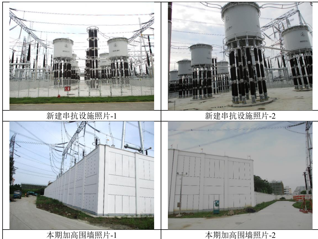
图 3-4 变电站本期规模设施照片
