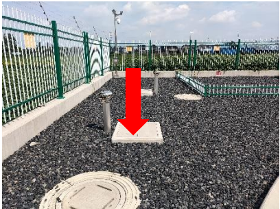
110kV 蒋垛变事故油池
