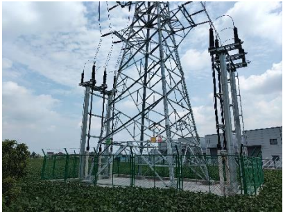
110kV 输电线路采用同塔双回和电缆敷设
