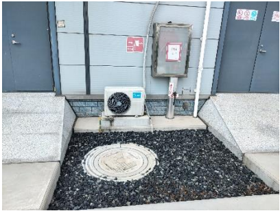
110kV 蒋垛变站内化粪池
