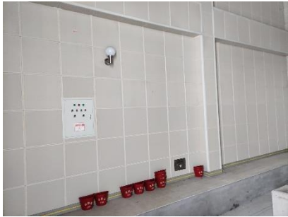
110kV 蒋垛变主变室内吸声材料
