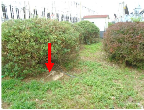
图6-1 220kV邓庄变化粪池照片
