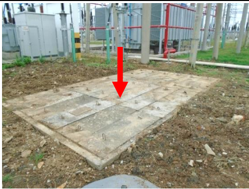
220kV邓庄变原有事故油池
