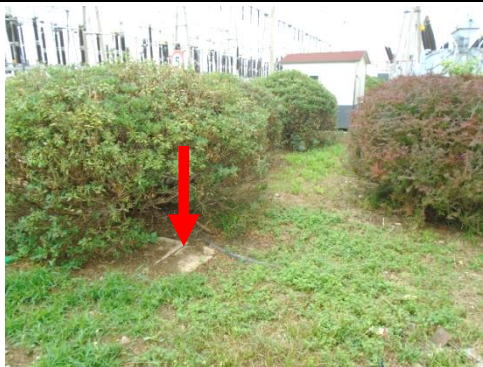
图 8-2 220kV 邓庄变化粪池照片
