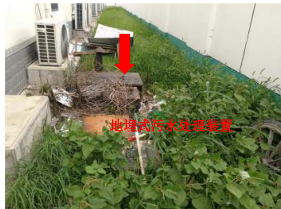
图 9-2 旗杰 500kV 变电站内生活污水处理装置
