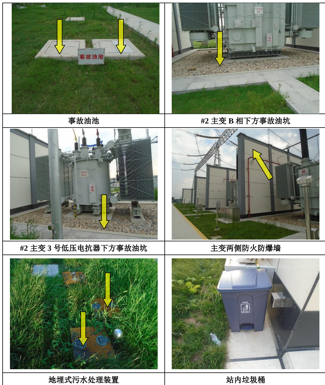
图 3-6 宿豫 500kV 变电站环保设施示例
