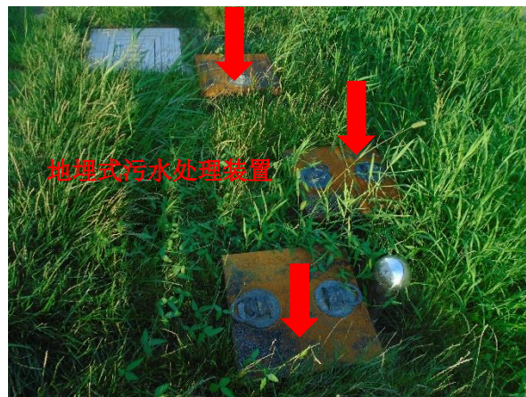
图 9-1 宿豫 500kV 变电站内生活污水处理装置
