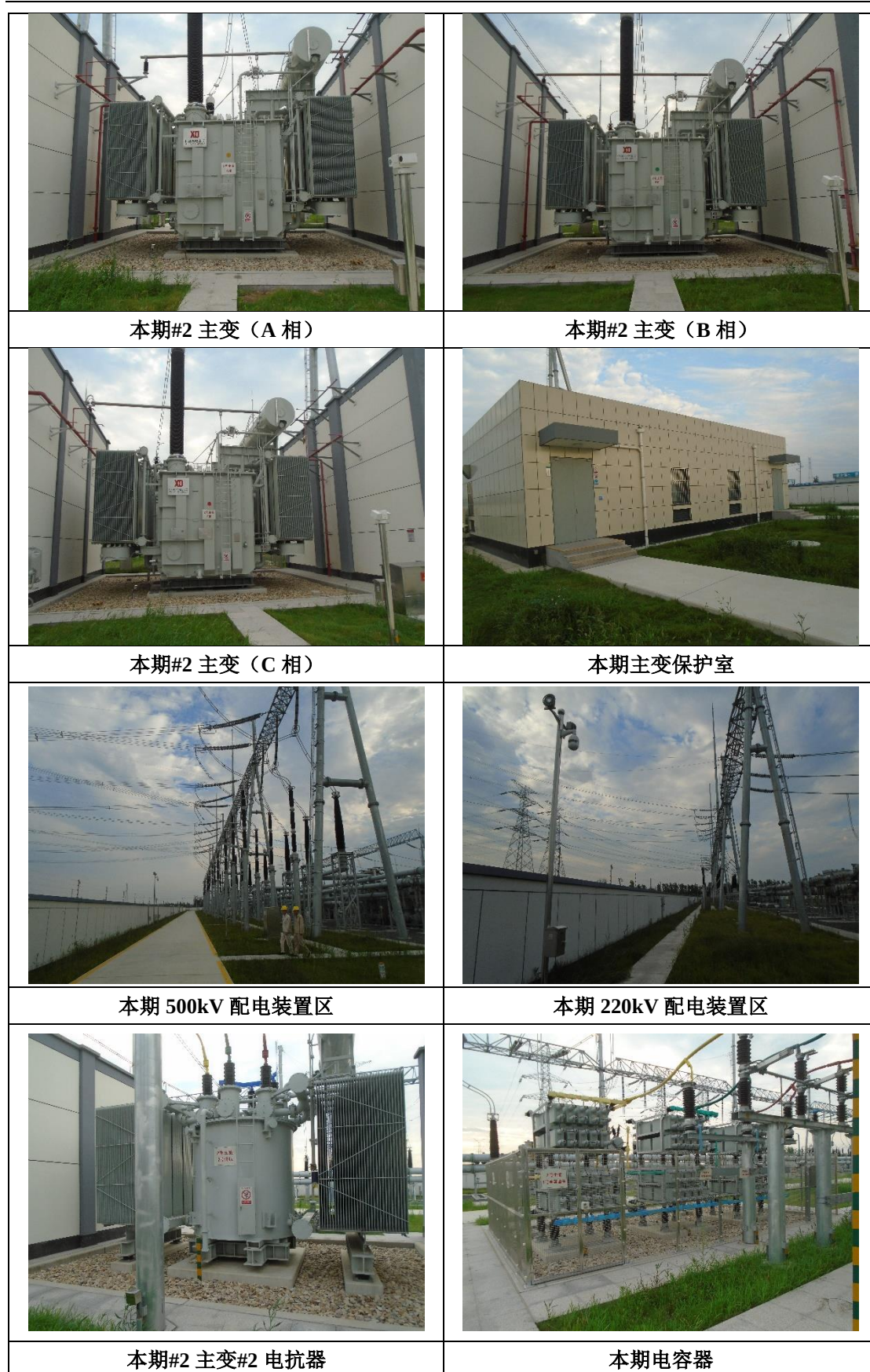
图 3-4 宿豫 500kV 变电站本期建设工程
