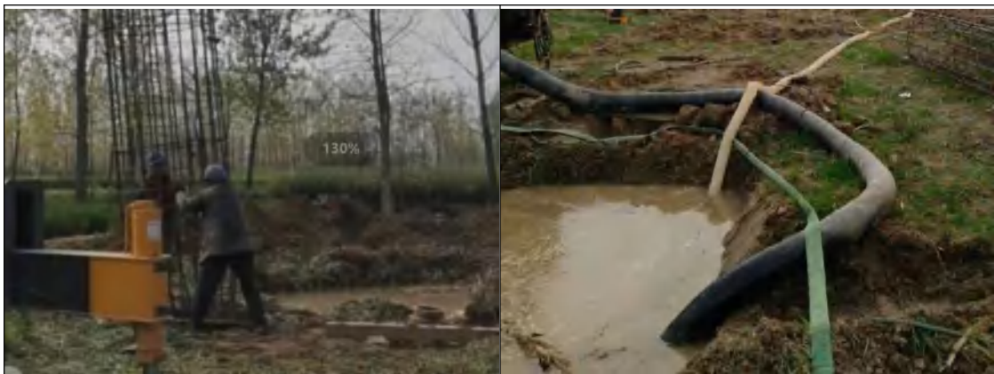
塔基区泥浆沉淀池（2020 年 5 月）
