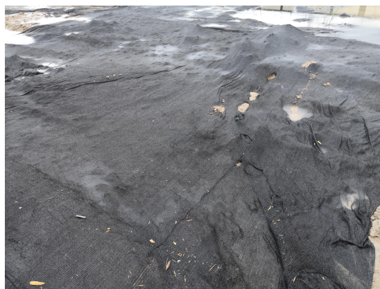
防尘网苫盖（黑色防尘网）
