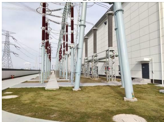
500kV 户内 GIS
