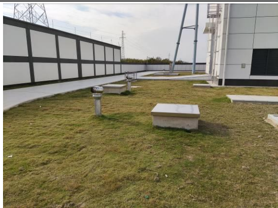
主变事故油池
