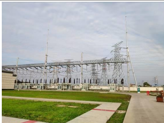
原有 220kV 配电装置区
