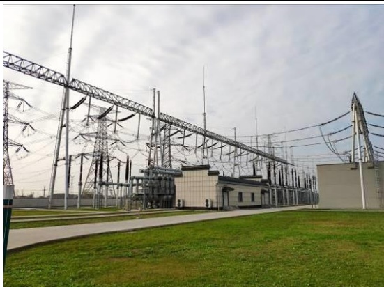
原有 500kV 配电装置区
