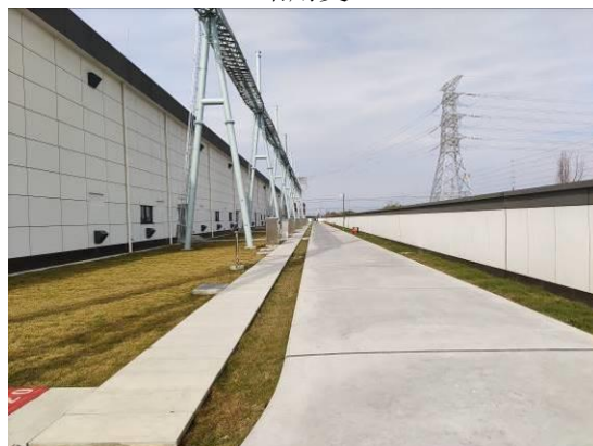
220kV 户内 GIS
