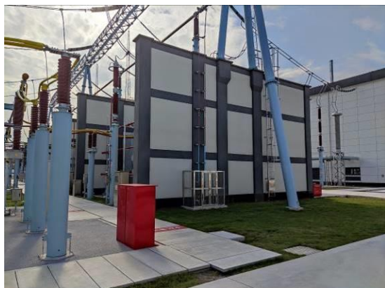
主变防火防爆墙
