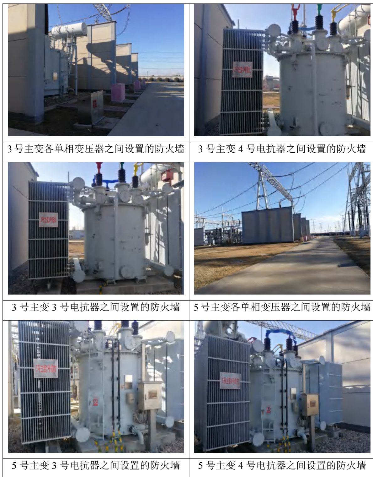
图 3.6 变电站主变及低压电抗器设置的防火墙（具有一定隔声效果）
