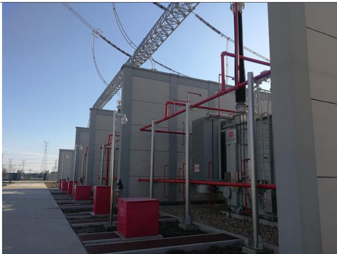
2号主变各单相变压器之间设置防火墙
