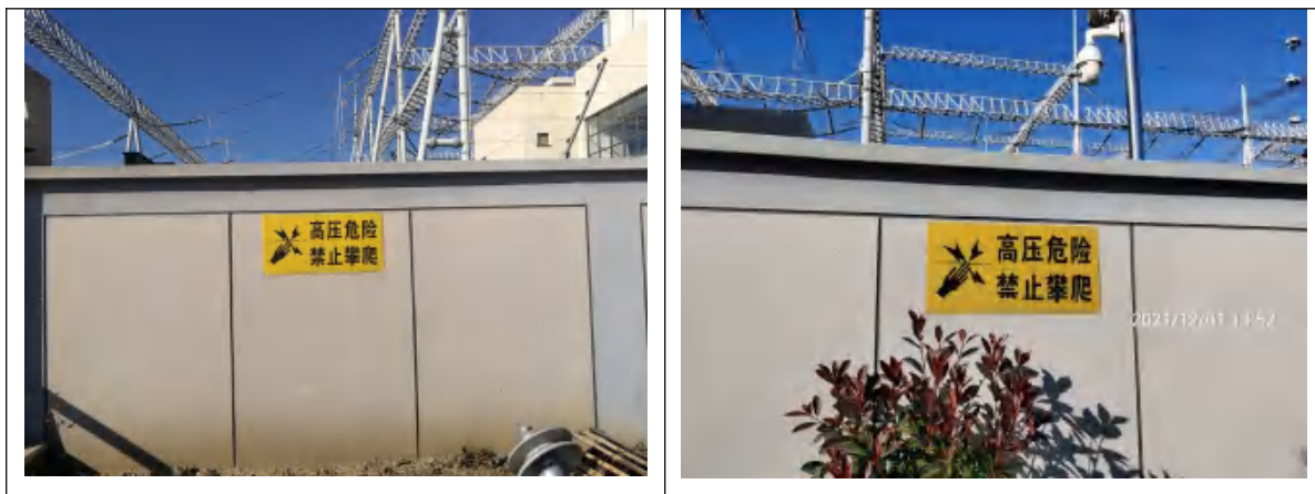
图 3.9 变电站围墙上设置高压危险禁止攀爬警示标志
