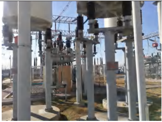
现有 3 号主变 1 号低压电容器
