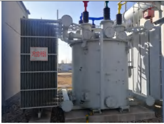
现有 3 号主变 3 号低压电抗器
