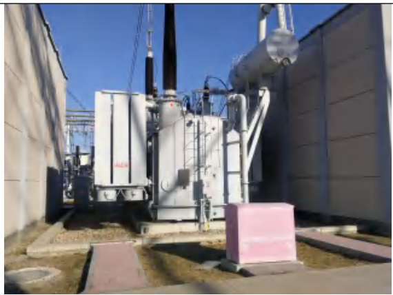
现有 5 号主变 C 相变压器
