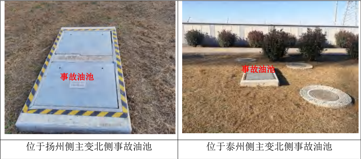
图 3.5 现有变电站已经建设的事故油池情况
