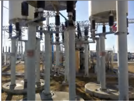
现有 3 号主变 2 号低压电容器
