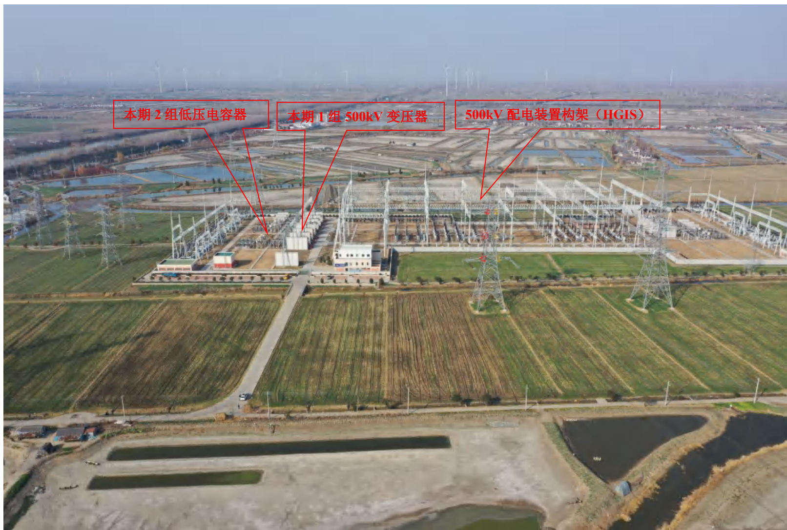
图 3.2 (a) 高邮（扬州北）500kV 变电站全景情况
