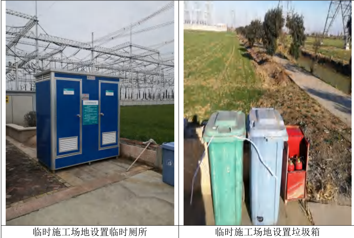
图 5.2 本期施工场地设置防治设施
