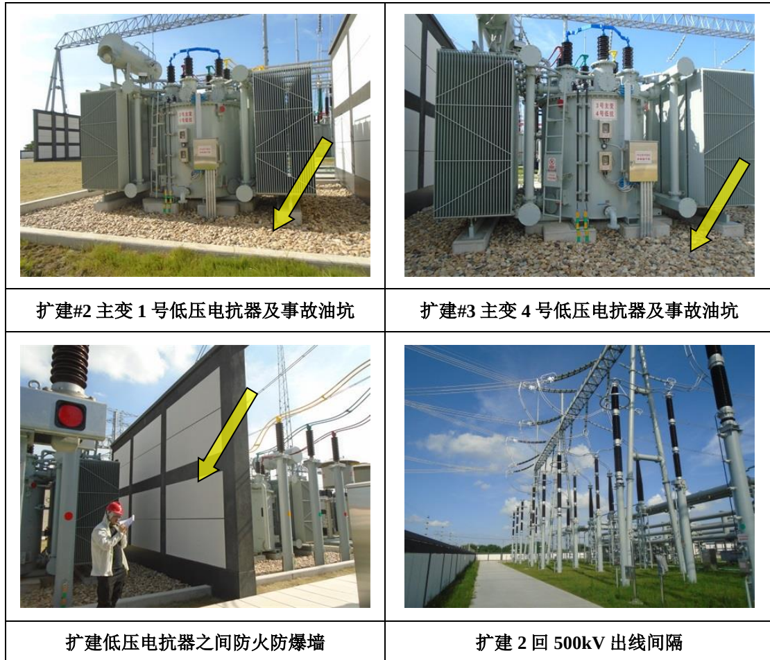
图3-1 吴江南500kV变电站原有规模设施及环保设施照片
