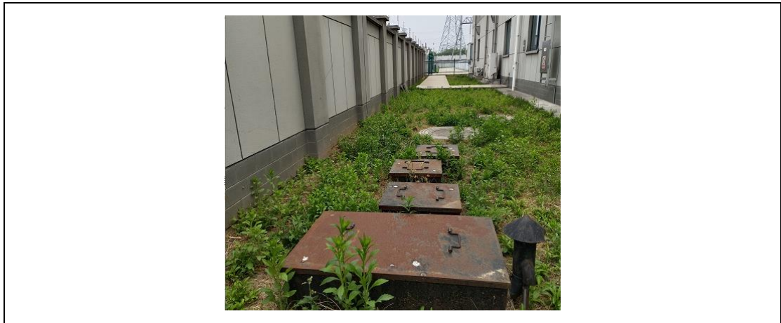
图 9-1 秋藤 500kV 变电站内地埋式污水处理设施
