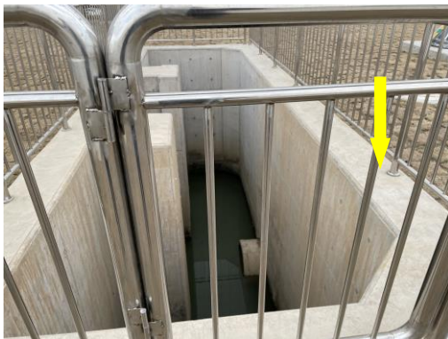
图 9-2 站内雨水泵站
