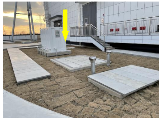
图 9-3 站内污水处理装置
