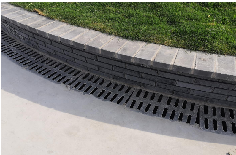
施工生产区临时排水沟（2020 年 5 月）
