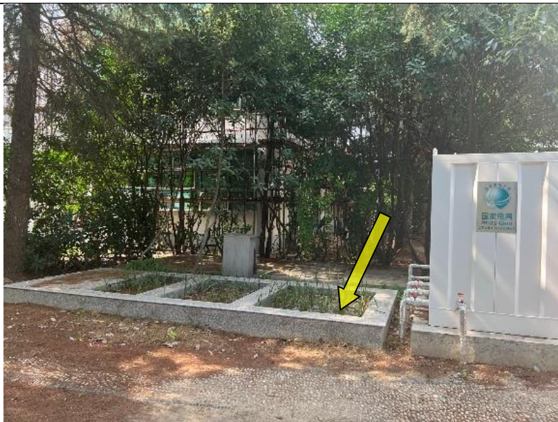
500kV 梅里变原有污水处理装置
