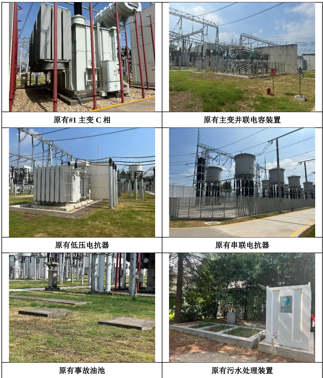
图3-1 梅里500kV变电站原有规模设施、环保设施照片
