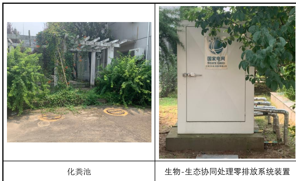
图 9.2-1 任庄 500kV 变电站前期工程化粪池
