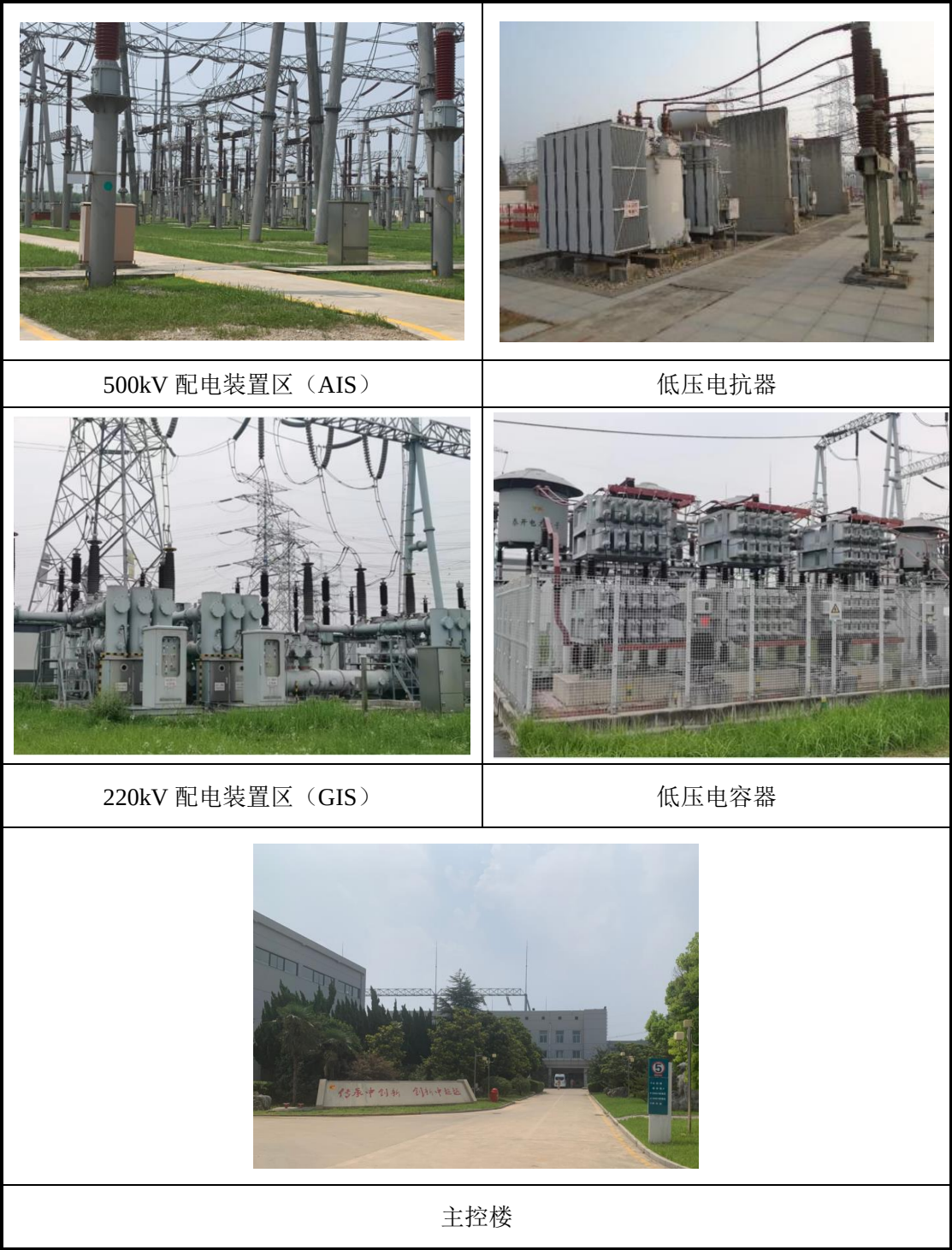
图 3.3-1 任庄 500kV 变电站前期工程内部设施
