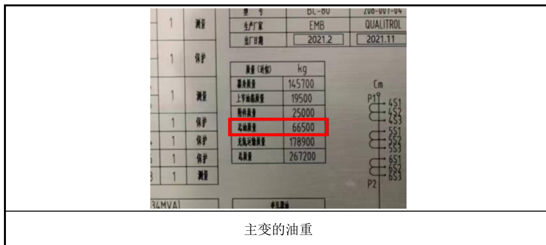
图 3.3-4 任庄 500kV 变电站本期新建主变压器铭牌照片
