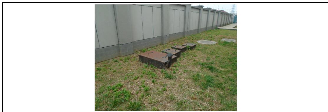
图 9-1 秋藤 500kV 变电站内地埋式污水处理设施
