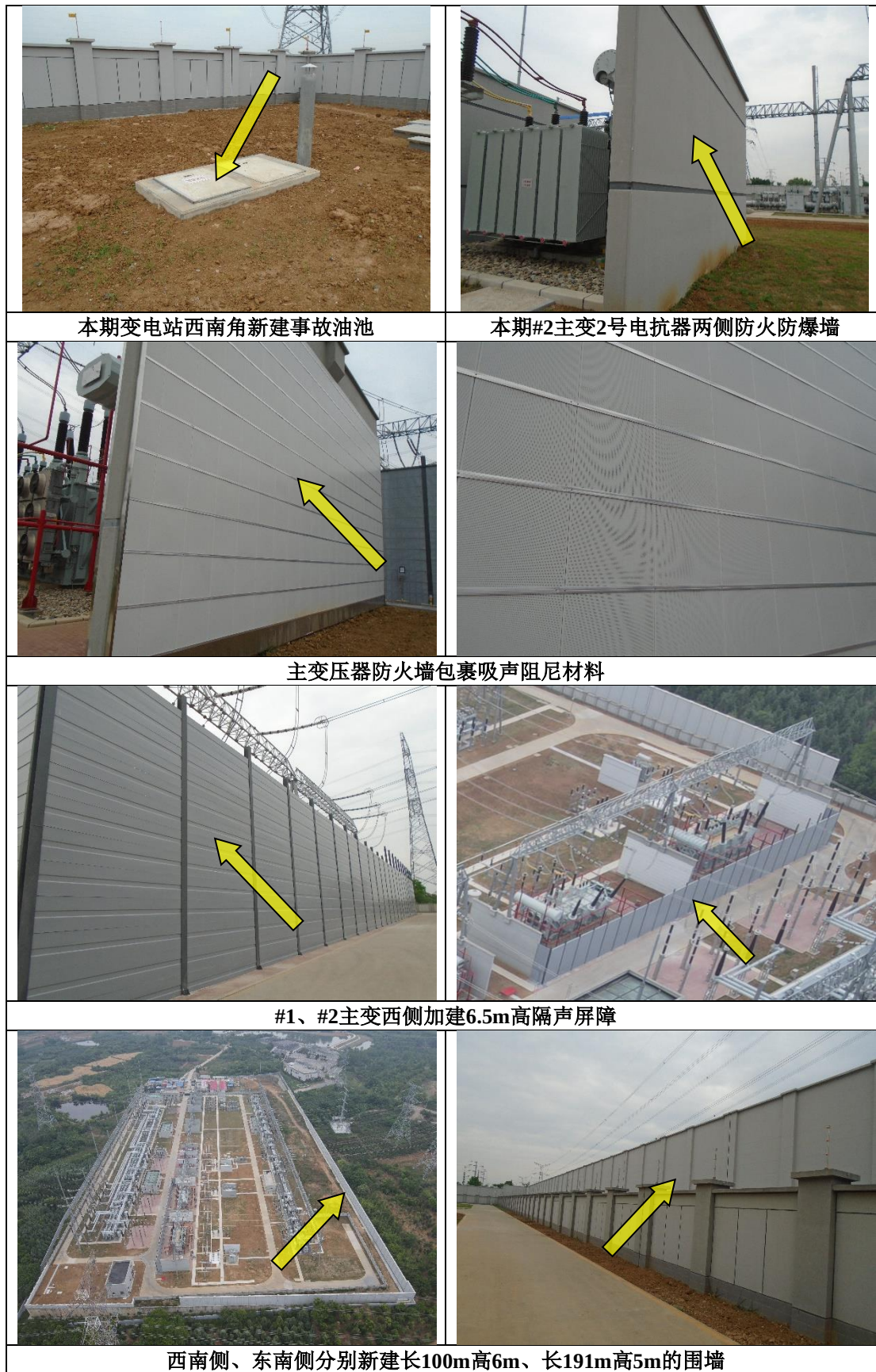
图3-4 秋藤500kV变电站本期工程环保措施
