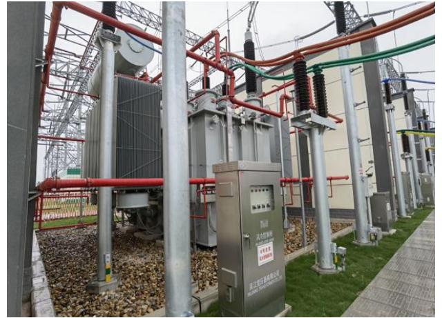
#6 主变事故油坑
