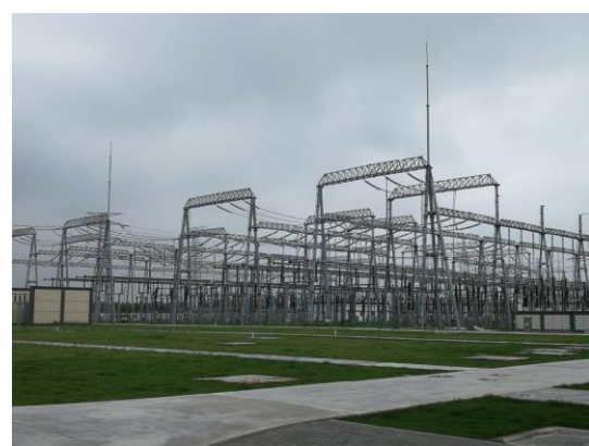
原有 220kV 配电装置区
