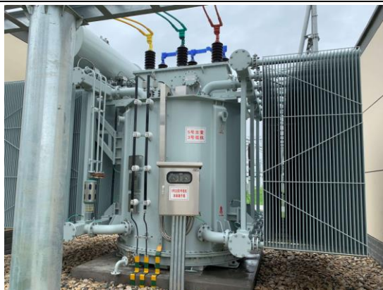
原有#5 主变 3 号低压电抗器
