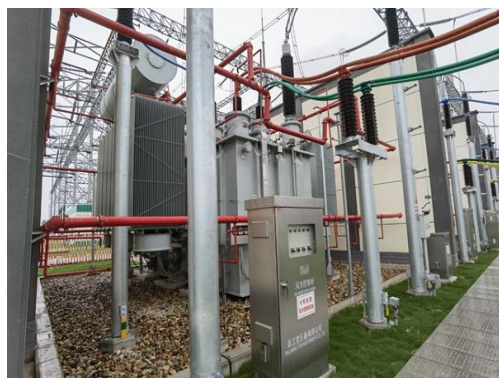
#6 主变事故油坑
