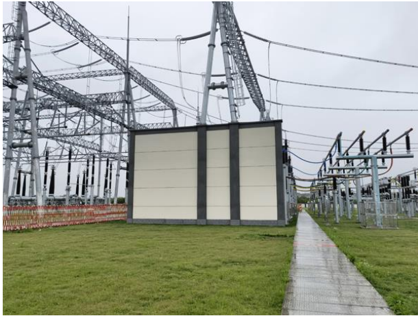
#6 主变防火防爆墙
