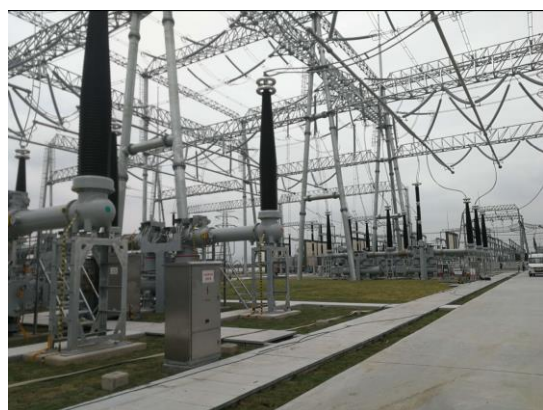
原有 500kV 配电装置区
