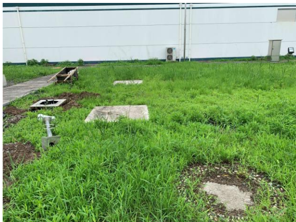
60m 3 事故油池
