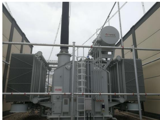
原有 500kV#5 主变 B 相
