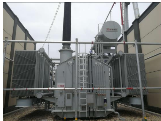
原有 500kV#5 主变 C 相
