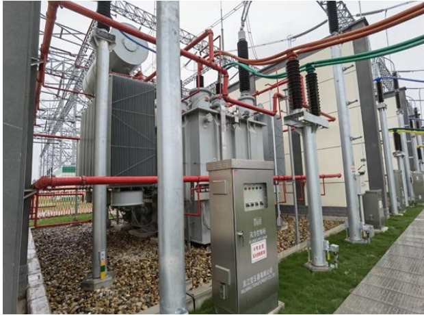
本期#6 主变事故油坑
