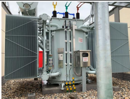
原有#5 主变 4 号低压电容器
