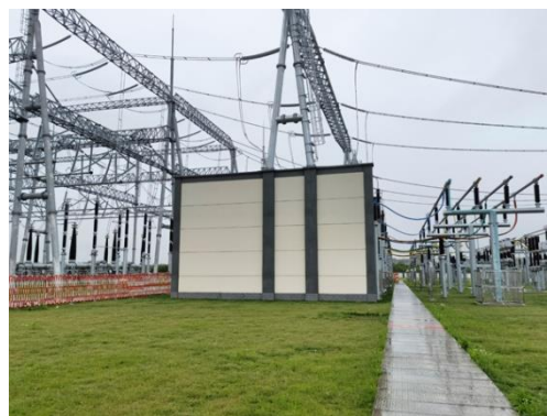
#6 主变防火防爆墙
