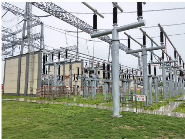
前期#5 主变防火防爆墙
