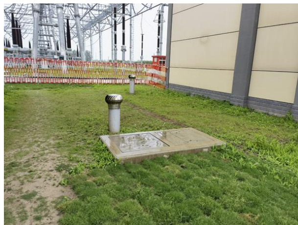
80m 3 事故油池
