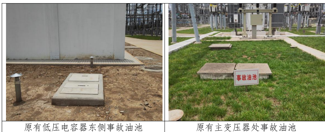
图3.8 老车坊500kV变电站设置事故油处置设施情况
