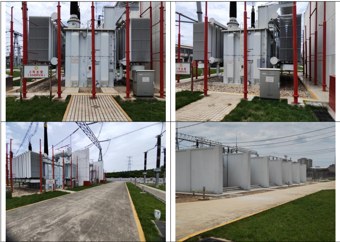
图 3.10 老车坊 500kV 变电站设置防火墙情况
