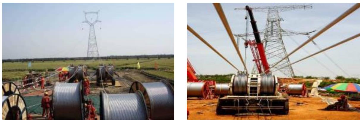
图 1.1-2 线路工程沿线牵张场布置形式照片
