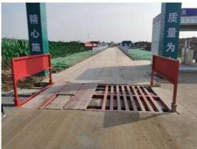
站区车辆清洁池（2021.9.15）
