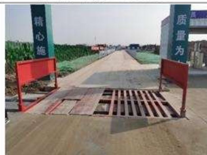
站区车辆清洁池 (2021.9.15)
