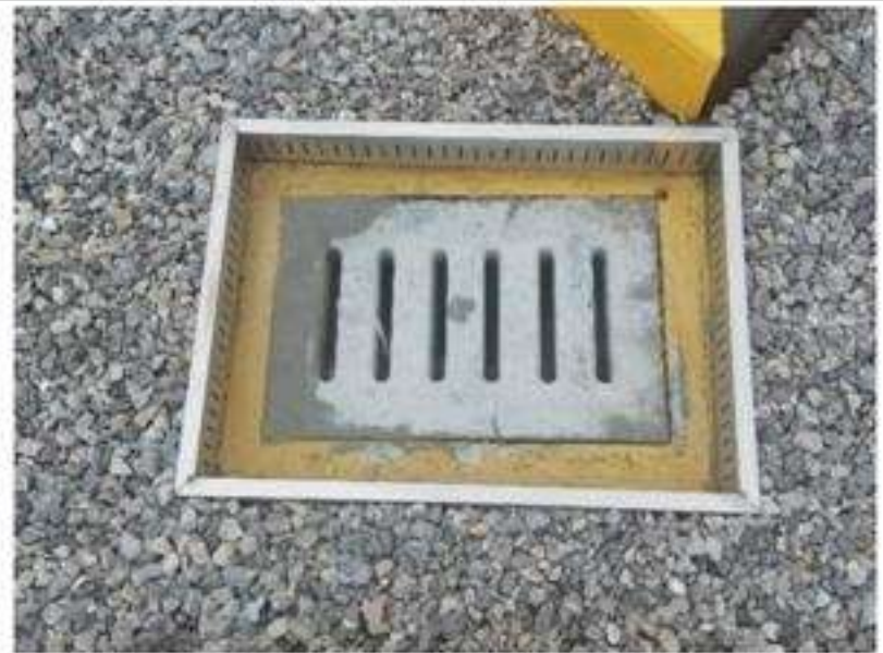
站区雨水管网雨水口（2023.1.11）
