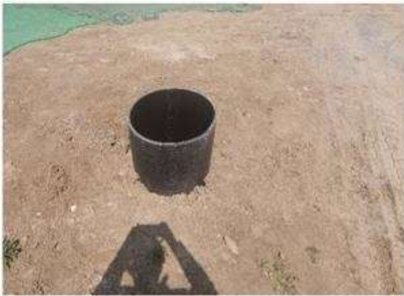
站区雨水管网（2021.4.19）
