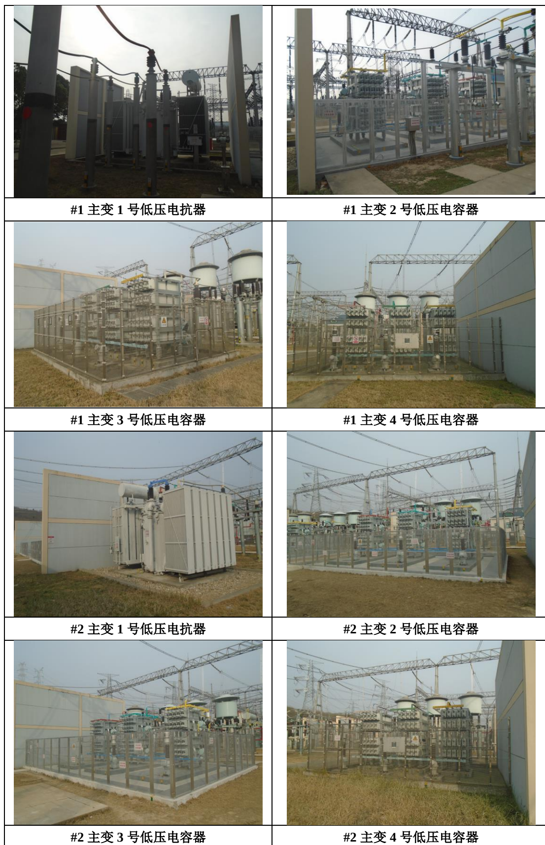
图 3-1 龙王山 500kV 变电站原有工程 (b)
