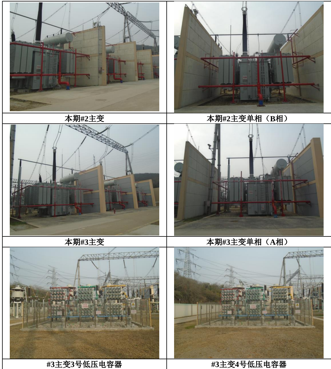
图3-3 龙王山500kV变电站本期工程
