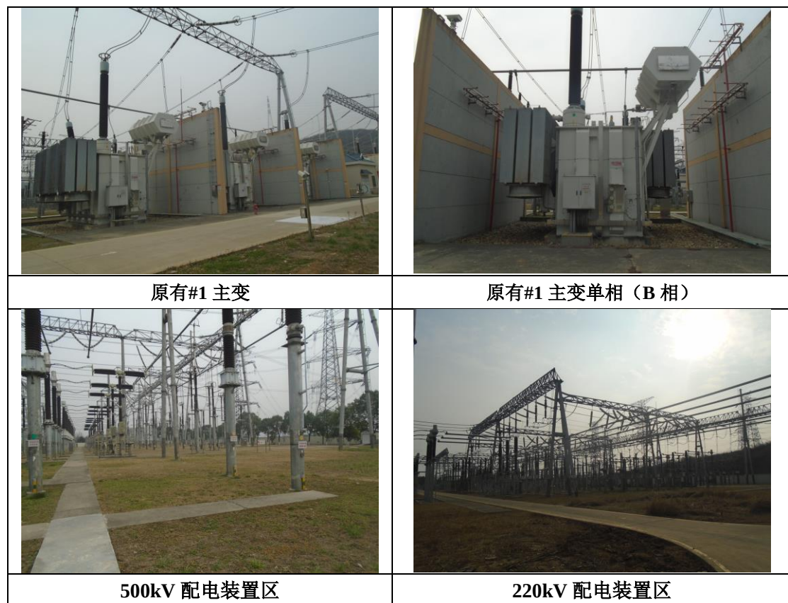
图 3-1 龙王山 500kV 变电站原有工程（a）
