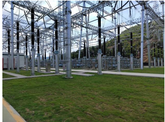
原有 220kV 配电装置区
