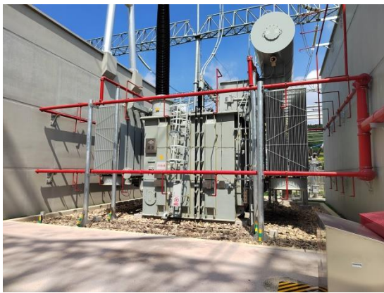
主变及防火墙
