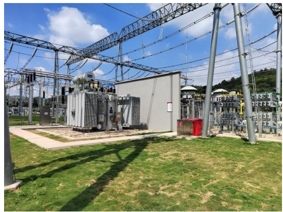
低压电抗器及防火墙
