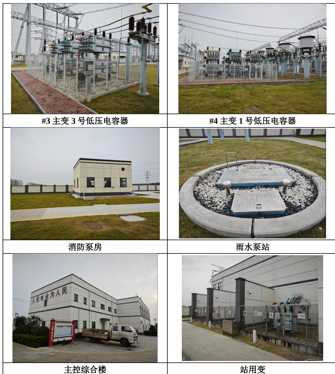
图 3-1 徐圩 500kV 变电站现有设施设备照片
