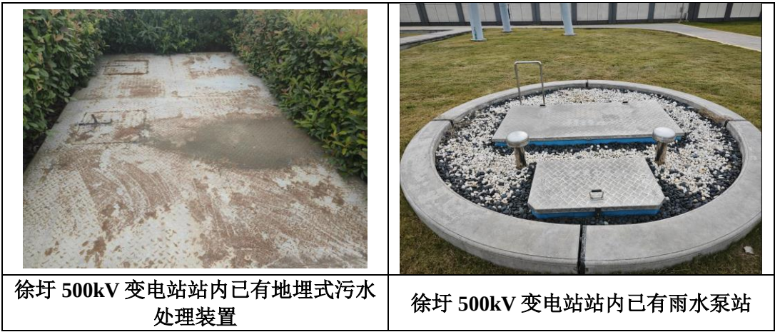
图 9-2 施工期和调试期污水处理设施
