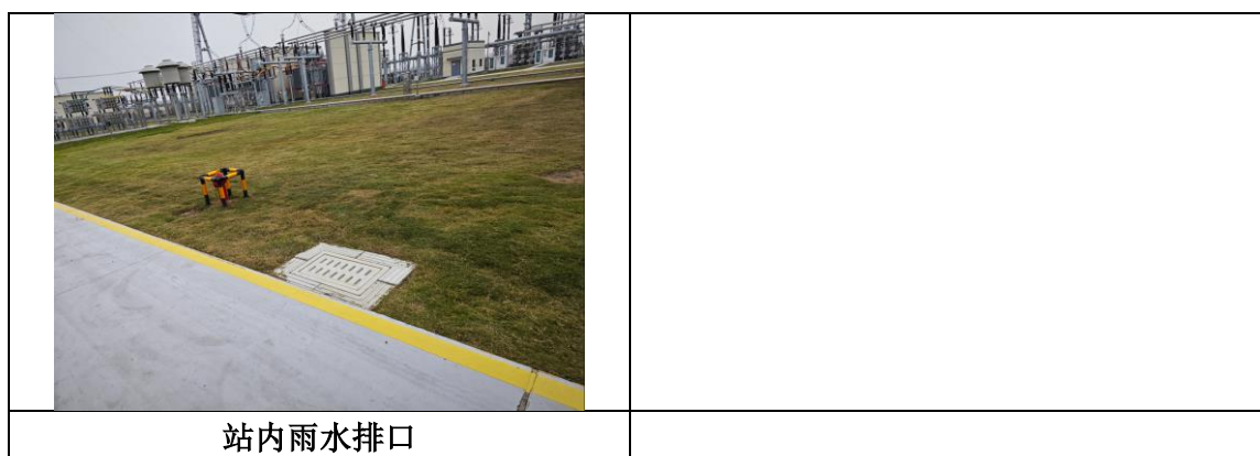
图 3-2 徐圩 500kV 变电站现有环保设施及措施照片
