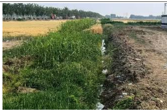
变电站区土质排水沟（2023.10）
