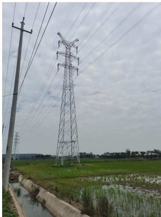
110kV 春新 7M74/春庄 7M89 线 31 号
