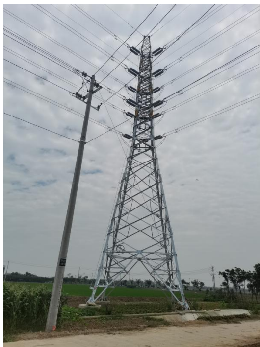
110kV 春新 7M74/春庄 7M89 线 30 号
