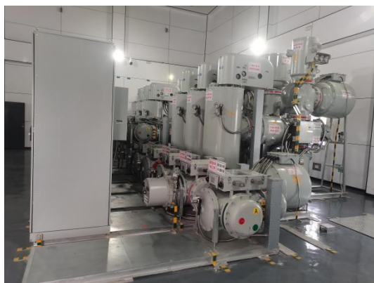
110kV 配电装置
