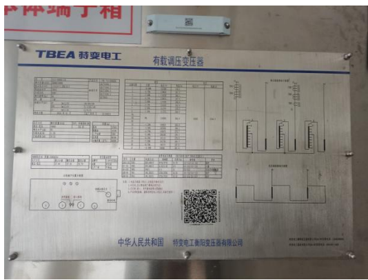
#1 主变铭牌（本期新建）
