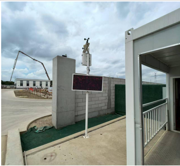
噪声、扬尘实时监控设备
