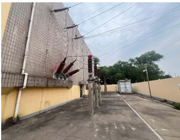
110kV 出线间隔
