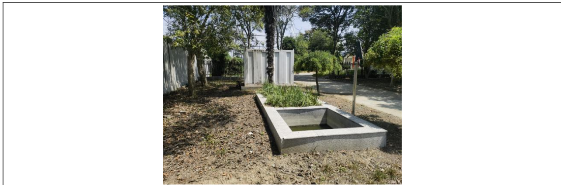
图 9-1 上河 500kV 变电站内景观式一体化污水处理装置
