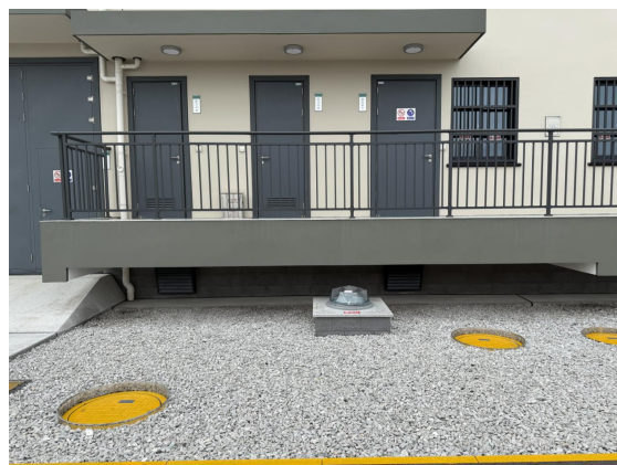
地埋式污水处理装置
