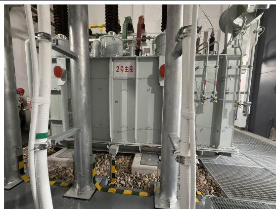
#2 主变及事故油坑
