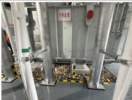
#1 主变及事故油坑
